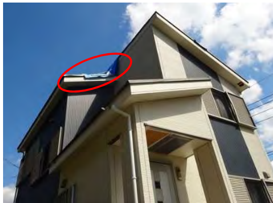
写真 30. 29と同じ建物。片流れ棟包み板金も飛散。
