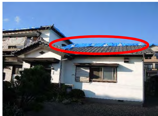
写真 11. 瓦屋根 (J形瓦) の棟部の被害
