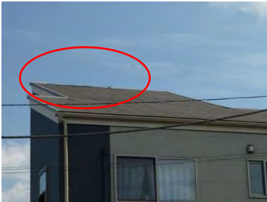
写真 48. 化粧スレート屋根の片流れ屋根。棟部が飛散。(築浅の建物)
