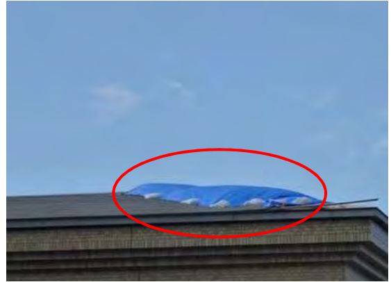
写真 43. 金属屋根（横葺き）。平部・棟部が飛散。
