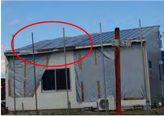
写真 35. 金属屋根（立平葺き・ガルバリウム鋼板）。ケラバ・平部・棟包みが飛散。
