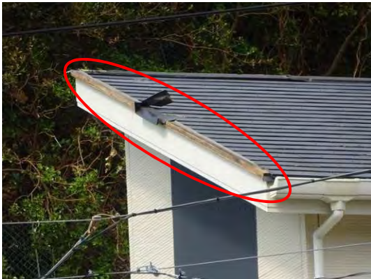
写真 29. 化粧スレート屋根。築年数の浅い物件。ケラバ板金が飛散している。見たことがない被害。
