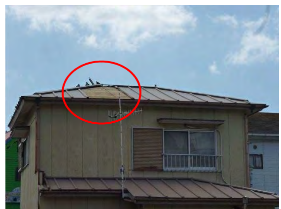
写真 47. 金属屋根（瓦棒葺き）。平部・棟部が飛散。（46の裏側）
