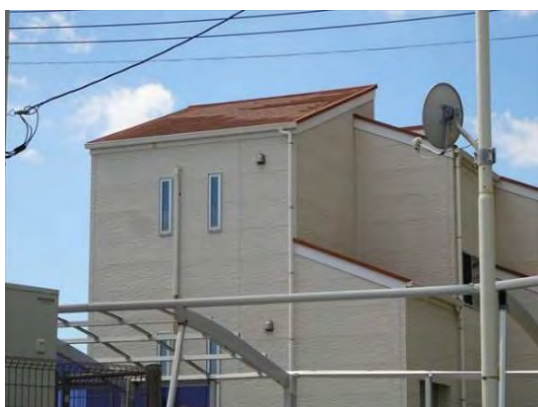
写真 25. 化粧スレート屋根。築年数の浅い物件。平部が飛散している。
