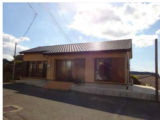
写真 53. 道路を挟んだ反対側の瓦屋根(F形瓦・防災タイプ)は被害なし。
