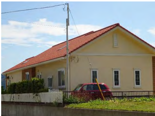
写真 27. 写真 25 の並びの築年数の浅い物件。瓦屋根 (S 形瓦・防災タイプ) は被害なし。
