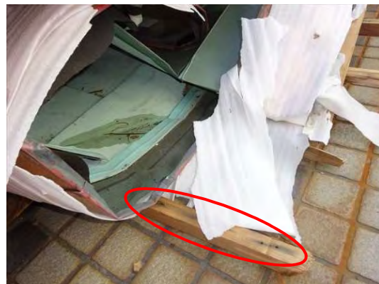
写真 51. 飛散したたる木には、結露痕が見られた。
