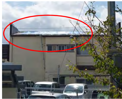
写真 38. 三方パラペット・金属屋根（瓦棒葺き）。平部、パラペット笠木が飛散。
