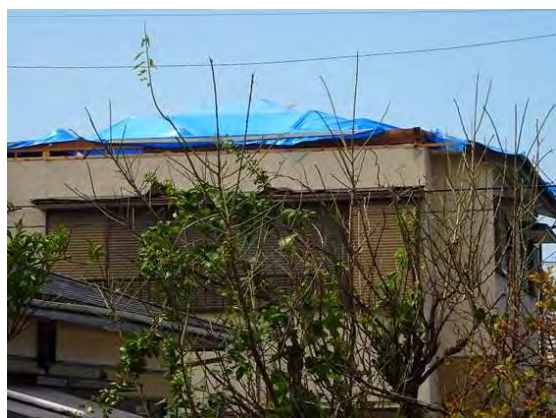
写真 19. 屋根下地から飛散。
