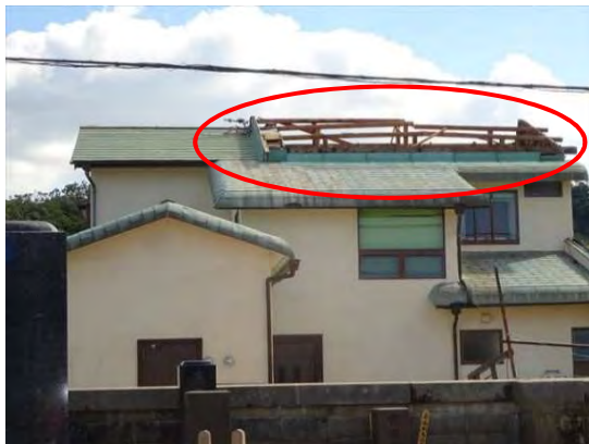
写真 50. 金属屋根(銅板葺き)。屋根下地(野地板・たる木)ごと飛散。
