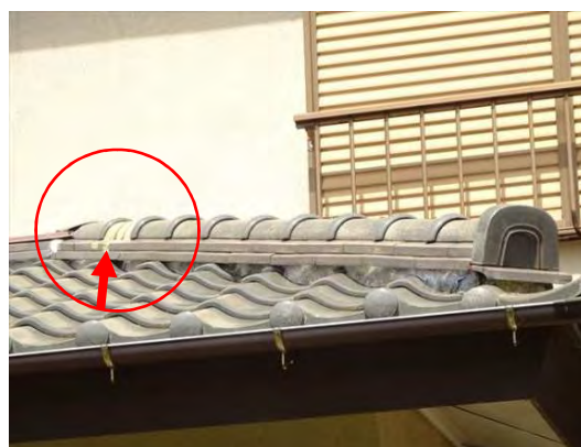
写真 16. 瓦屋根 (J 形瓦) : 棟部 (のし 2 段+冠瓦)。一部の冠瓦がずれた。冠瓦の留め付けは 1 枚ずつ銅線により緊結。
