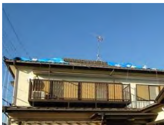
写真4. 瓦屋根（J形瓦）棟部の被害
