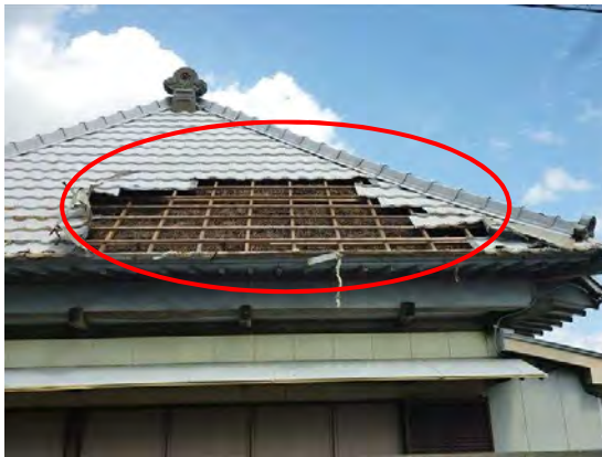
写真 44. 金属屋根（瓦型タイプ）。平部が飛散。
