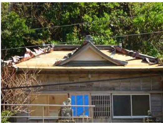
写真 33. 金属屋根（銅板葺き）。浅間神社。銅板の平部が飛散。
