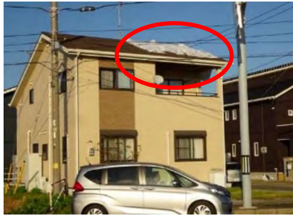
写真 9. 化粧スレート屋根の棟部・平部の被害
