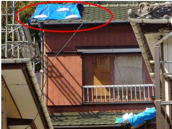
写真 54. 瓦屋根 (F 形瓦・非防災タイプ) には被害が見られた。(築年数が 20~30 年なので防災タイプではない。)
