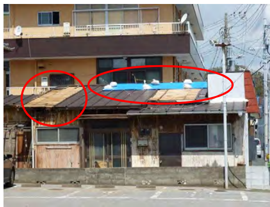
写真 41. 金属屋根 (瓦棒葺き)。平部、棟部が飛散。
