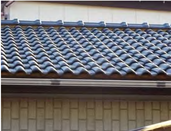
写真 8. 瓦屋根 (F形瓦・Mタイプ) の被害なし (ガイドライン準拠)
