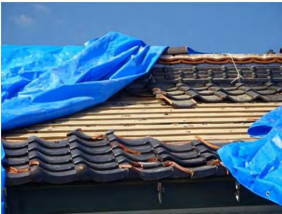
写真 22. 瓦屋根 (J 形瓦)。平部の棧瓦が飛散。くぎ打ちなし。棟部も冠瓦が飛散。
