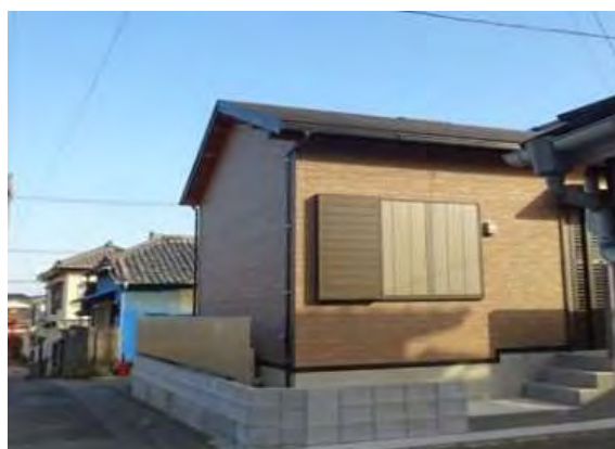
写真7. 化粧スレート屋根（平家）被害なし
