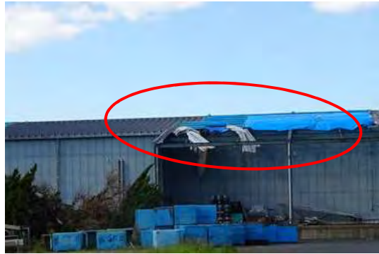
写真 36. 金属屋根（折半葺き）。工場・倉庫の金属屋根も飛散。
