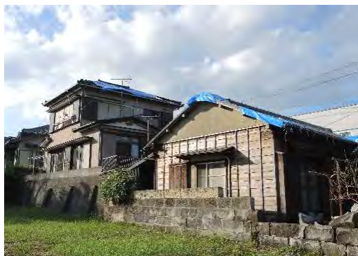
写真 12. 瓦屋根 (J形瓦) の棟部・平部の被害
