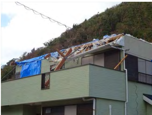
写真 31. 化粧スレート屋根。屋根下地・小屋組が飛散。
