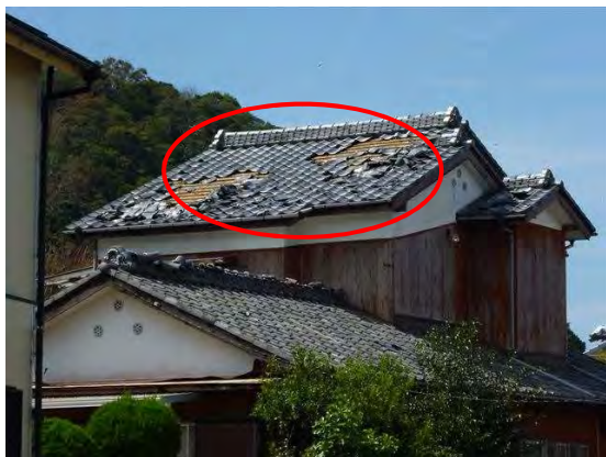
写真 40. 瓦屋根 (J形瓦)。平部が飛散。くぎ打ちなし。棟部は飛散なし。
