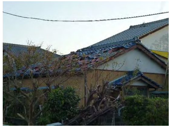
写真 55. 瓦屋根 (J 形瓦) は平部被害あり。くぎ留めされていない。
