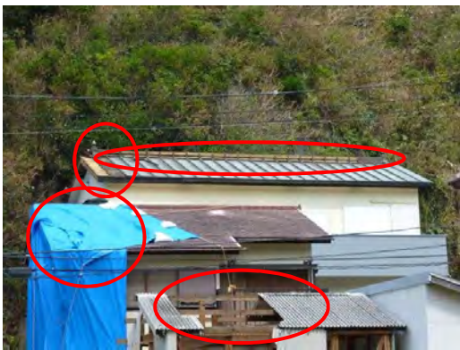
写真 37. 金属屋根（瓦棒葺き）。ケラバ・平部・棟包みが飛散。その下の化粧スレート屋根も同様。
