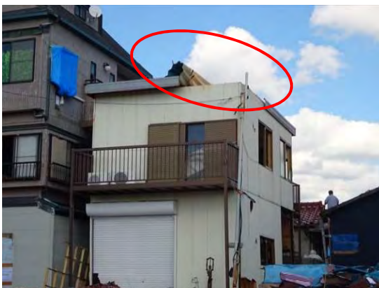
写真 52. 金属屋根(折半葺き)が半分めくりあがっている。
