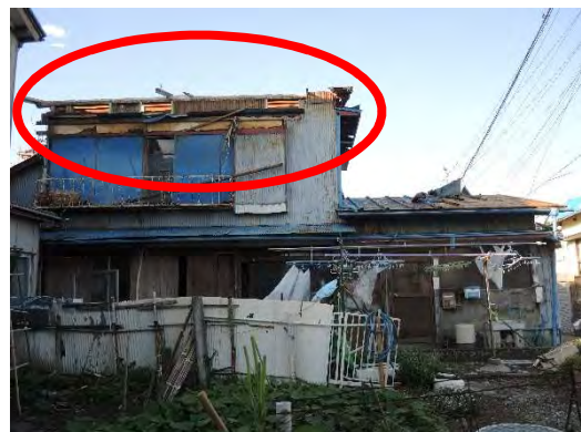
写真 13. 金属屋根 (瓦棒葺き) が屋根下地ごと飛散した被害
