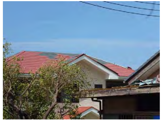
写真 45. 化粧スレート屋根。平部・棟部が飛散。（黒色は塗装前の色）
