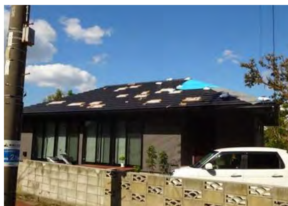
写真5. 瓦屋根（F形瓦）飛来物による被害
