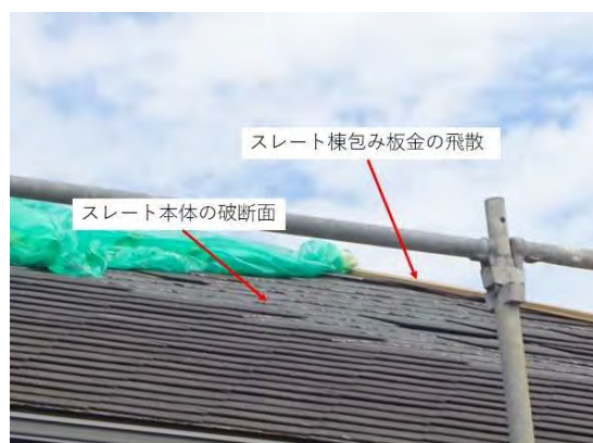
写真 18. スレート本体の破断面の様子。くぎ抜けは発生していない。
