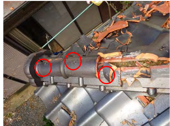
写真 23. 瓦屋根 (J 形瓦)。棟部の冠瓦は下から銅線で留め付け。2 階の屋根根から飛散した瓦による破損。
