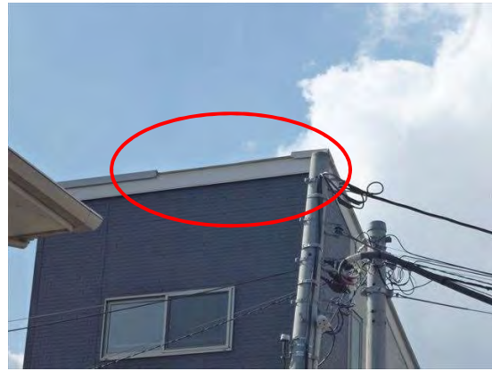
写真 49. 片流れ屋根。棟包み板金が飛散。(48の裏側)
