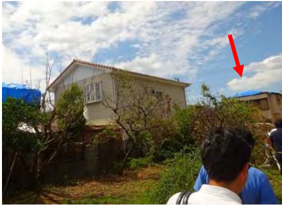
写真 21. 瓦屋根 (F 形瓦・防災タイプ) は、被害なし。築 10 年程度の比較的新しい建物。右隣のブルーシート (⇒) は、写真 19 の屋根下地が飛散した屋根。
